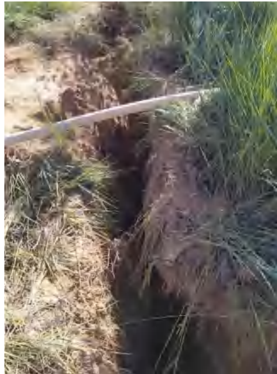
照片 3-5 以往地面塌陷区地裂缝
