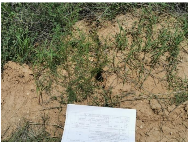
照片 3-17-1 较窄的地面塌陷裂缝 1
