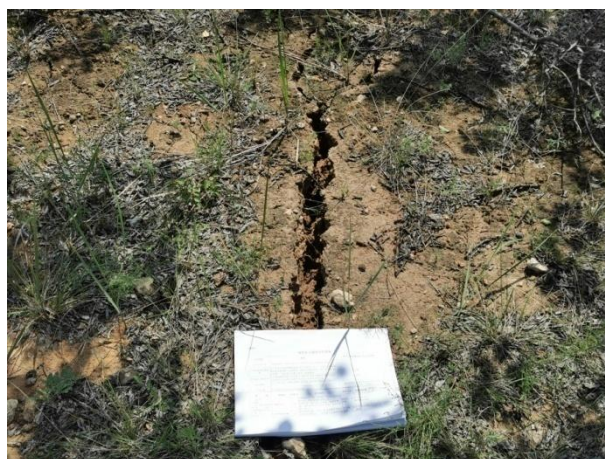
照片 3-17-2 较窄的地面塌陷裂缝 2
