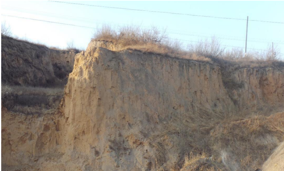
照片 3-2 崩塌现状情况
