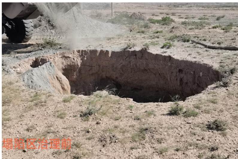
照片 2-9 地面塌陷坑治理前照片
