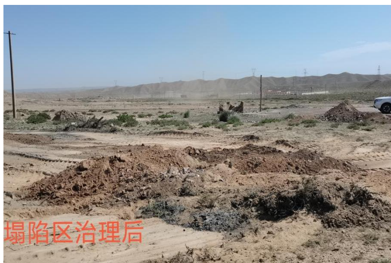
照片 2-11 地面塌陷坑治理后照片
