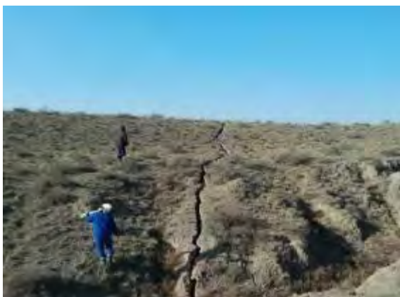
照片 2-7 治理前地裂缝
