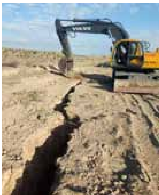
照片 2-1：回填地面裂缝
