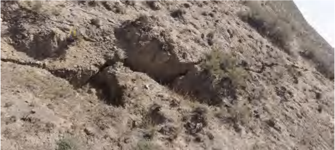
照片 3-6 地面塌陷伴生裂缝
